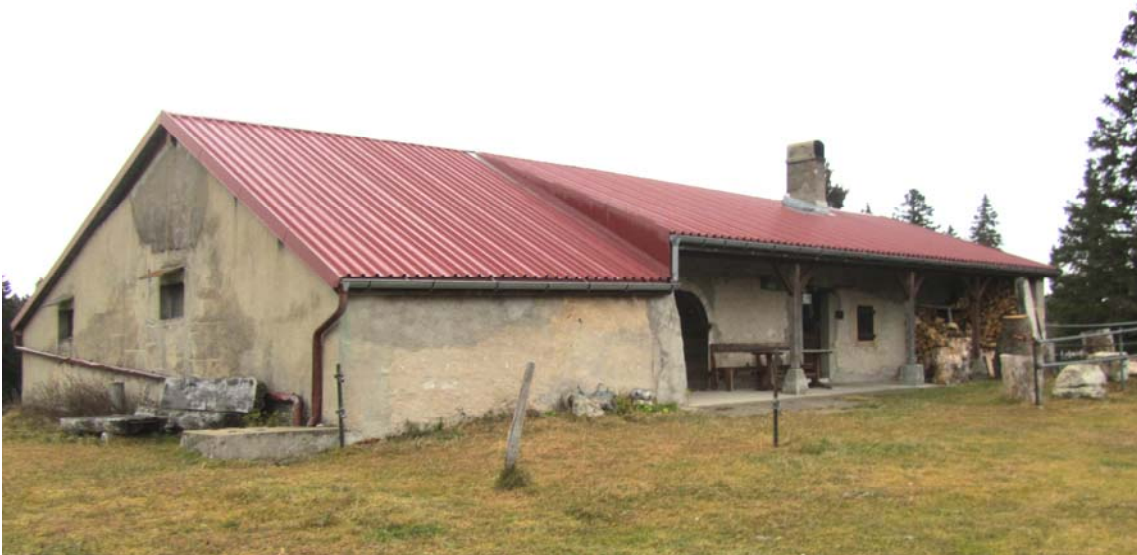
Le devant, heureusement, réserve des surprises. C'est un vieux chalet qui garde encore des éléments architecturaux intéressants, notamment une belle porte d'écurie, avec l'encadrement de pierre de taille en voûte. Le grand avant-toit permet de dégager un large espace où l'on peut boire un verre en toute sécurité et tranquillité.
